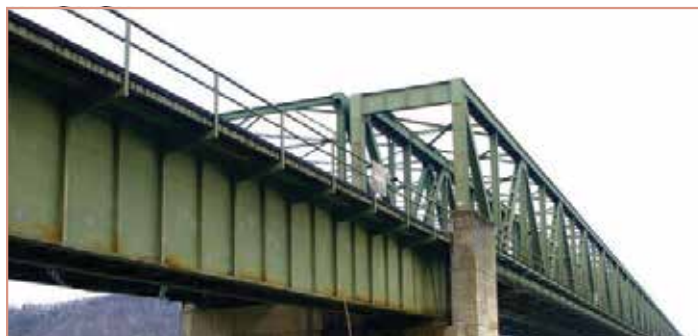
Deutlich sichtbare Mängel an der Donaubrücke. © Gemeinde
