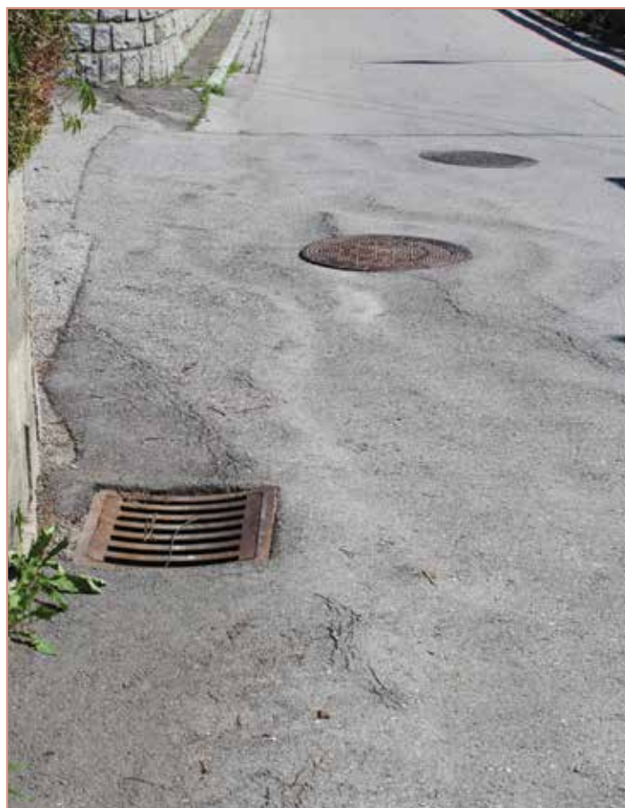
Schwere Beschädigungen an der Ufer Straße. © Gemeinde
